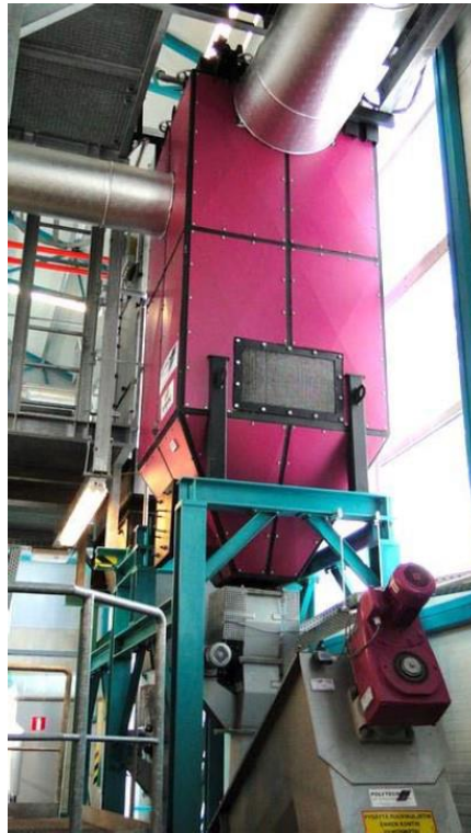
33. ábra Levegő előmelegítő (LUVO)
