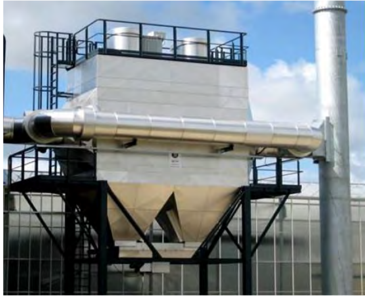
32. ábra Porleválasztó elektrofilter
