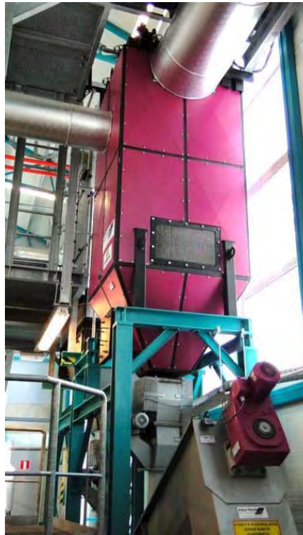
33. ábra Levegő előmelegítő (LUVO)
