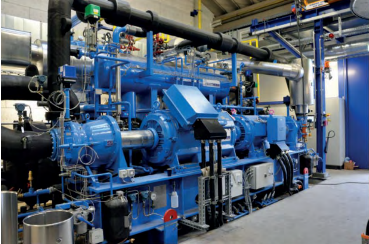
12. ábra Az egyik 5,75\text{ MW} teljesítményű hőszivattyú [11]
