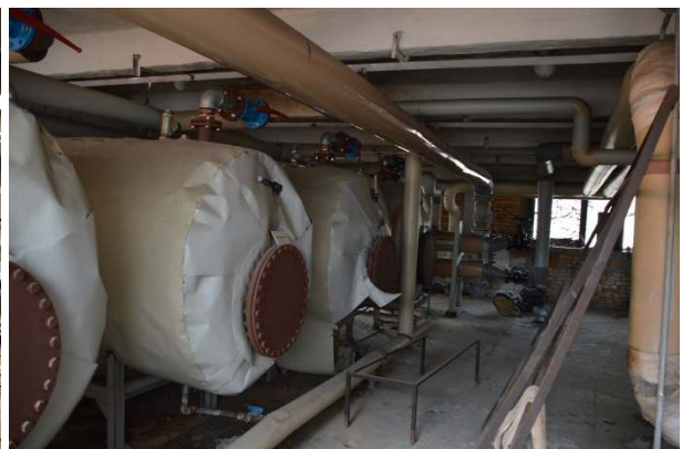
187. ábra Melegvíz tartályok a déli épületrész galériaszintjén
